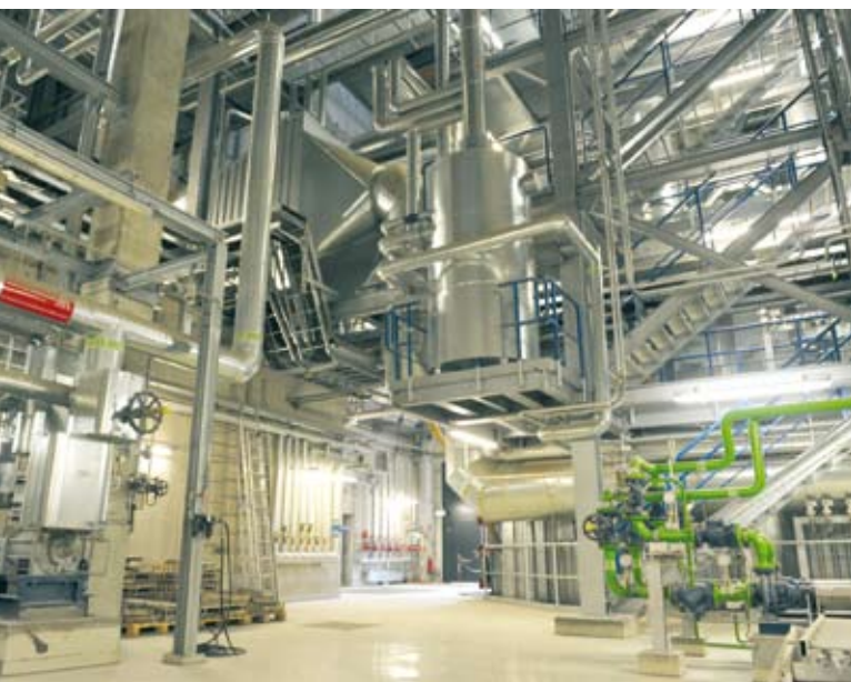
Das Biomasse-Heizwerk der EVN liefert Naturstrom und Naturwärme und sorgt für eine CO 2 -Reduktion um 13.500 Tonnen.
