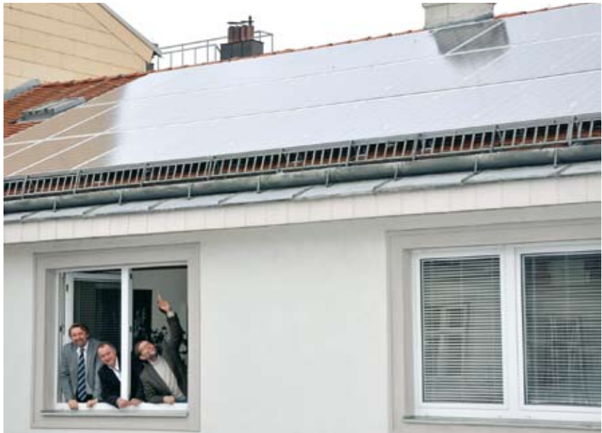
Auf dem uneinsehbaren Dach zum Innenhof des Gemeindeamtes wurde bereits im Jahr 2011 eine Photovoltaik-Anlage mit einer maximalen Leistung von 7,68 kWp installiert. Bei Volleinspeisung wird sie sich in etwa 7 Jahren rechnen. „Die Stadt will mit gutem Beispiel vorangehen“, so Bürgermeister Hans Stefan Hintner und Vizebürgermeister Gerhard Wannemacher.
